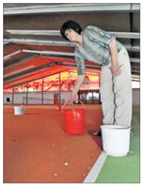
Mit Eimern versucht Karin Rosin das Wasser aufzufangen, das in die Halle tropft. Surrey
